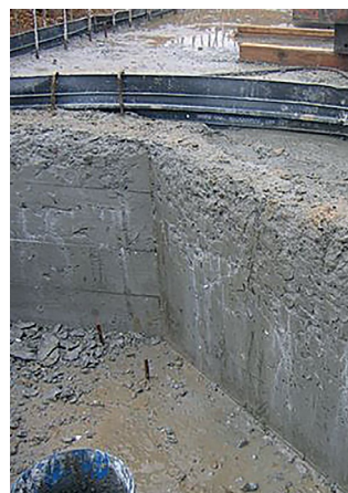
Zdjęcie 1. Uszkodzenie ściany fundamentowej wskutek przemrożenia świeżego betonu. Fot. Grzegorz Bajorek
