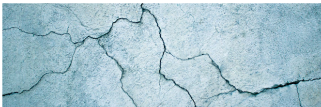
Zdjęcie 2. Pęknięcia na skutek nieprawidłowej zimowej pielęgnacji betonu
